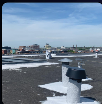
VENTILATIONS ET TUYAUX
