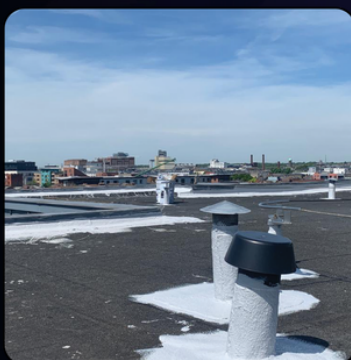
VENTILATIONS ET TUYAUX
